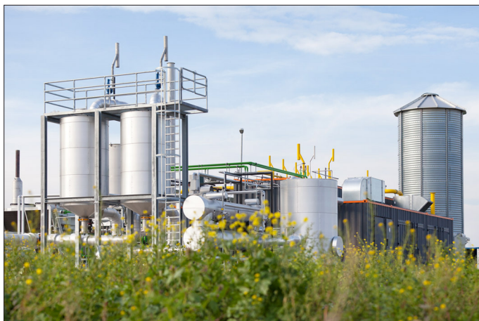
Das Bild zeigt eine baugleiche ETW-Anlage die im Jahr 2014 in Betrieb genommen wurde.
