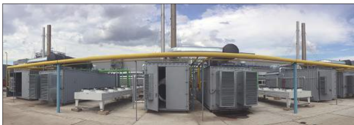
Die Inbetriebnahme der letzten ETW Anlagen enthält drei Blockheizkraftwerke mit einer Leistung von je 2.000 kW. Sie werden mit Erdgas versorgt und erzeugen somit eine elektrische Leistung von insgesamt 6.000 kW elektrisch und 3.021 kW thermisch.
